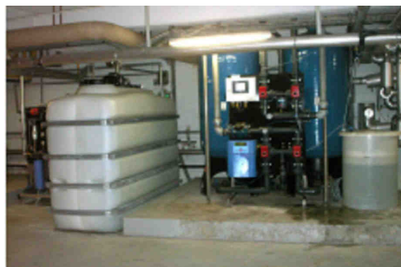
Vista de la planta de tratamiento de agua en el sótano de Regionsvaskeriet A/S en Aalborg.
